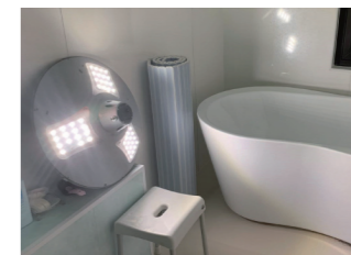
SIGEN-SC 室内点灯 (浴室)
